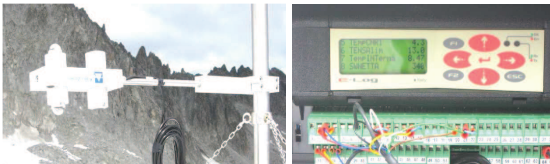
Fig. 4.5: il radiometro e il display interno del data logger (foto M. Donati, 30-07-2010).
