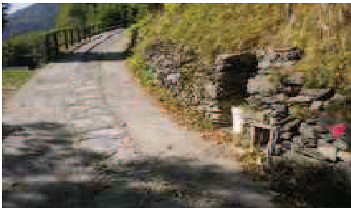
Figura 5.1 – Bollino rosso su muro a secco in prossimità di una fontana.
