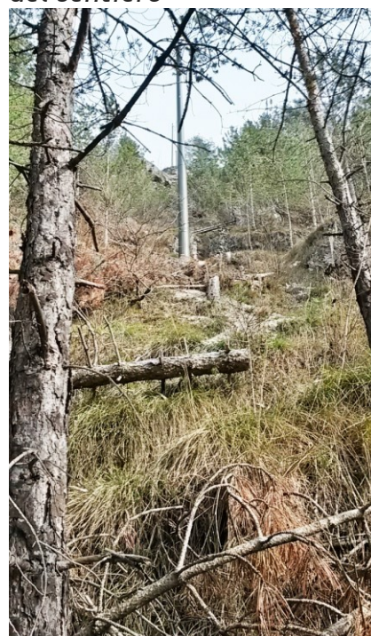
Figura 12 I lavori per l'impianto dei pali elettrici che ha causato la distruzione del sentiero
