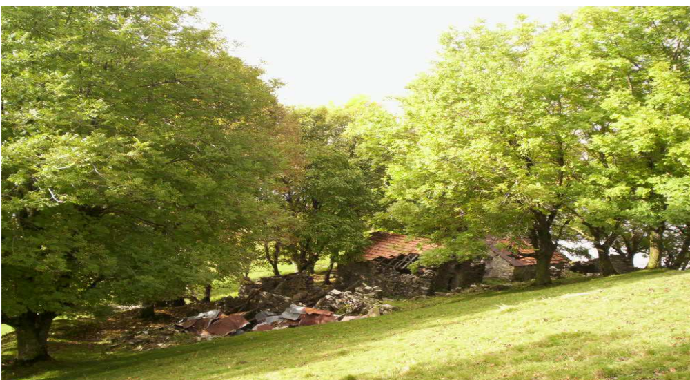
Figura 53. Condizioni di degrado dei fabbricati
