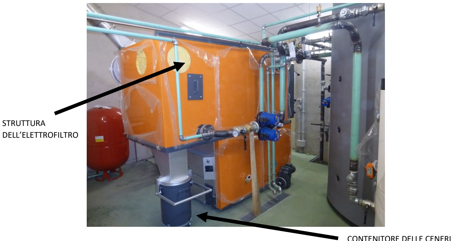
Figura 18: Elettrofiltro tubolare adiacente alla camera di combustione superiore.
