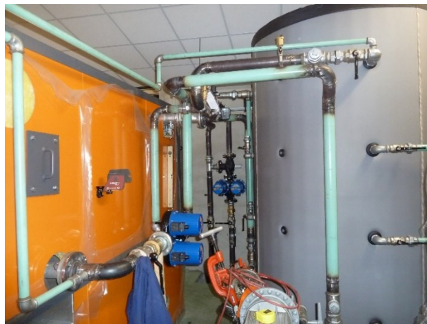
Figura 17: Puffer con allacciamenti alla caldaia.
