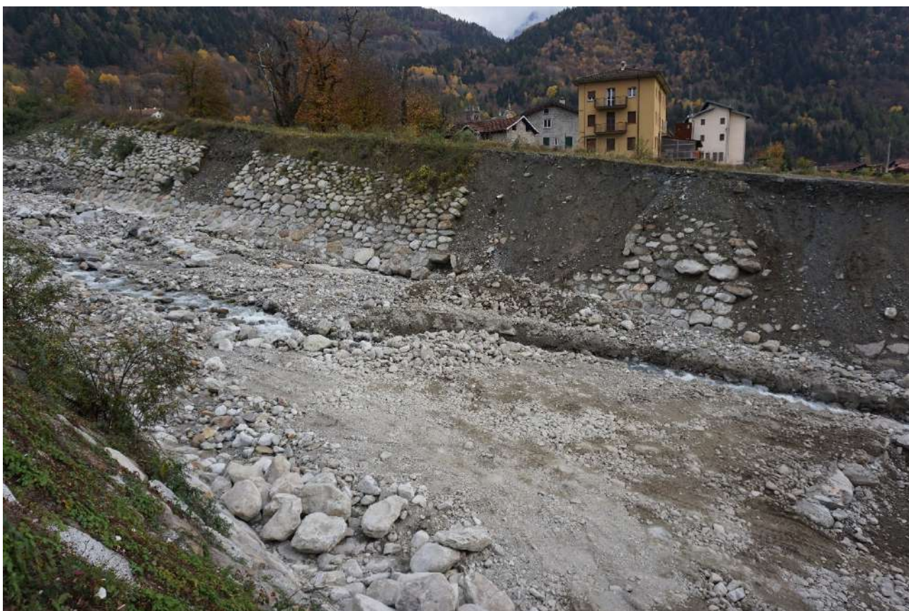
Figura 2- Fotografia risalente a novembre 2020 del t. Rabbia in seguito ad un evento di colata. Le conseguenze si manifestano con l'accumulo di materiale in alveo e con grossi danni alle opere di difesa spondale.
