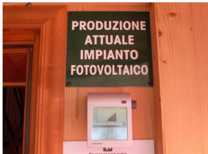
Figura 8.10 - Impianto fotovoltaico del rifugio Shambalà
